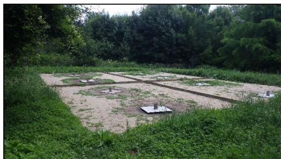
Photo 4 : Filtres à sable
