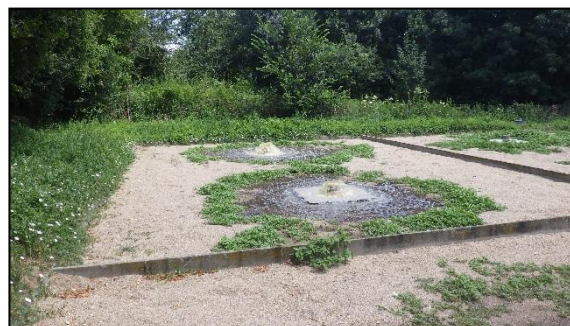
Photo 5 : Filtre à sable
